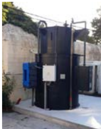
Exemple de poste hors sol
